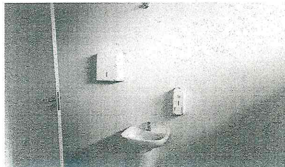
Figura 4- INSTALAÇÃO DE DISPENSER DE SABONETE.
